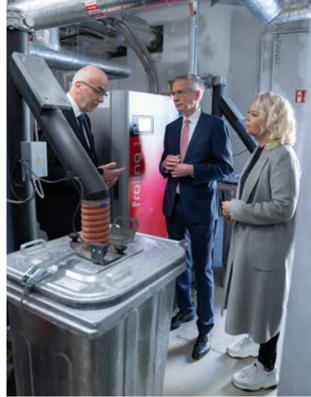
Die Holzpelletanlage arbeitet so effizient, dass sich der Aschebehälter nur ganz langsam füllt.
